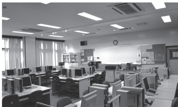
小中学校の校舎でエアコンが設置されているのは保健室とコンピューター室のみ (写真は更別中央中学校)
