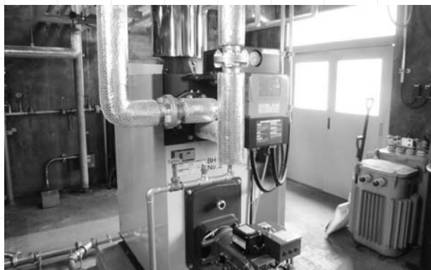
大規模改造工事に合わせ更新されたボイラー
