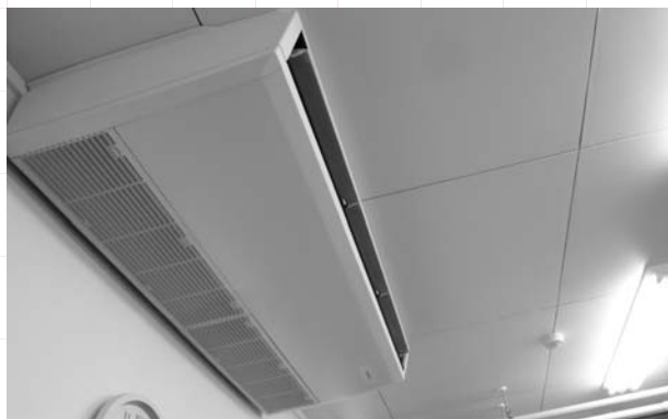
大規模改造工事に合わせ新設された空調機器
