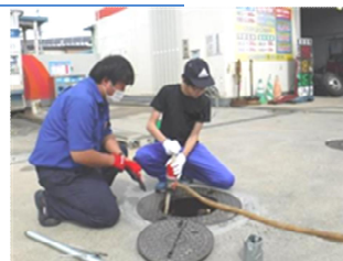
【ヤマジョウガソリンスタンド】 地下にたまった雨水を吸い上げる
